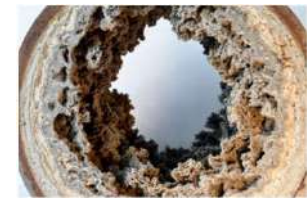
Scales in einer Rohrleitung DOE, USA [38]
